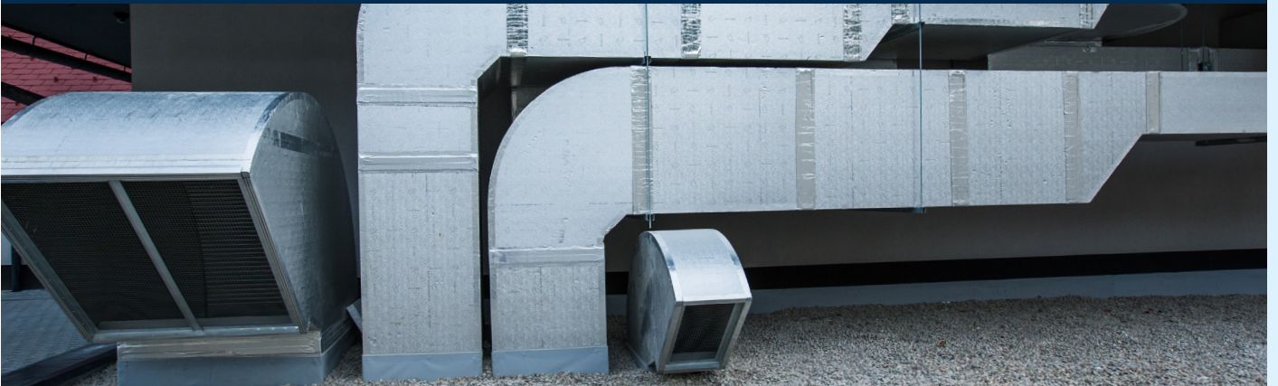
Lüftungsleitungen und Kanäle
