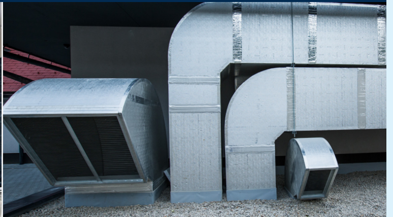
Lüftungsleitungen und Kanäle
